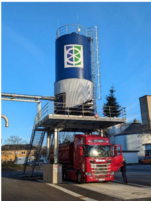
Verladung von Klärschlamm aus dem Hochsilo
